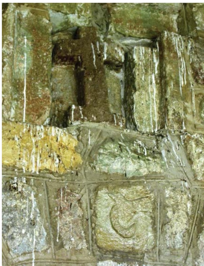
Figura 23. Fragmento de la fachada del atrio principal de la iglesia colonial de Pari, Junín, mostrando piezas líticas en contexto secundario (reusadas), una de ellas con alto relieve (compare con la figura 18). Lamentablemente en mal estado de conservación. Foto Gori Tumi 2008.
