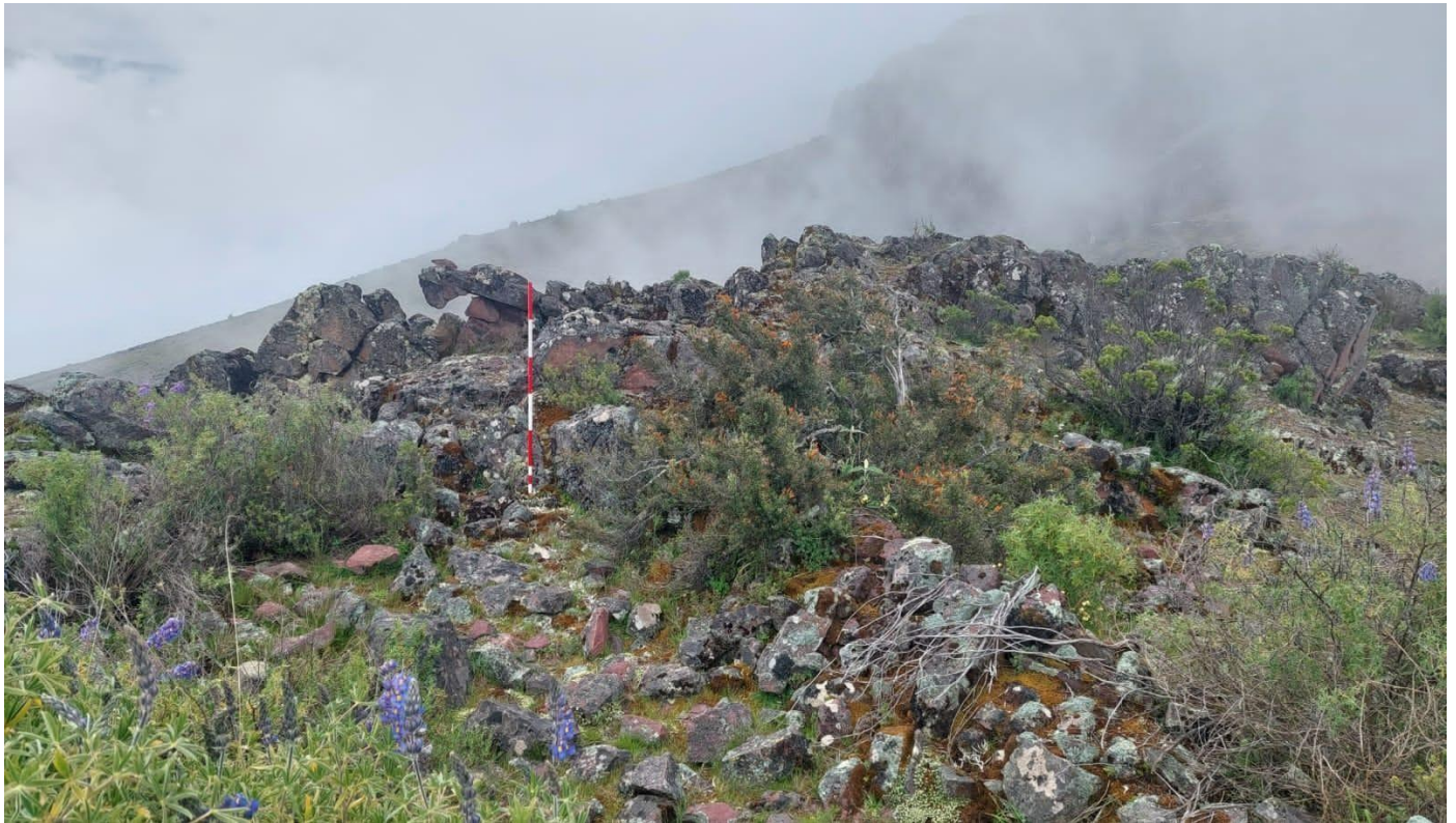
Figura 25: Recinto 1 respecto al sector A en el cual se puede apreciar el colapso y el adosamiento con el recinto 2.
