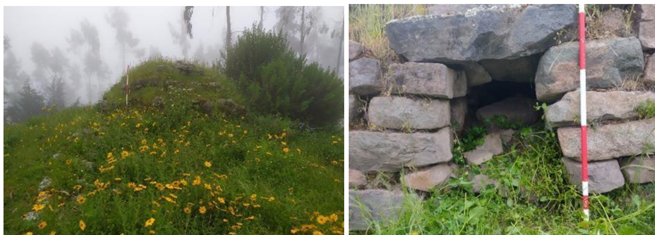
Figura 50 (izquierda): Imagen del sitio dirección SW-NE, se puede apreciar la cabeza de muro que pudo haber existido, sin embargo, la vegetación dificulta esta tarea. Figura 51 (derecha): Vano encontrado, nótese la galería colapsada. Foto tomada en dirección NW-SE.
