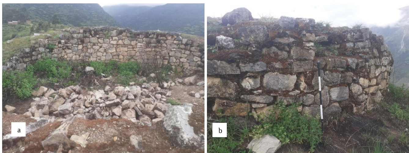
Figura 13. (a) Vista del paramento interno y las piedras acumuladas en el centro que forman parte del derrumbe la pared. (b) Detalle del paramento externo.
