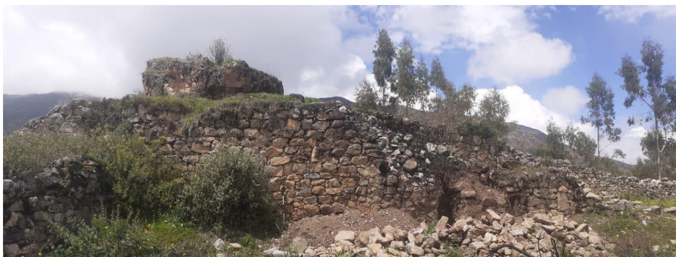
Figura 11. Vista panorámica del muro afectado por la quema de la maleza que lo cubría.
