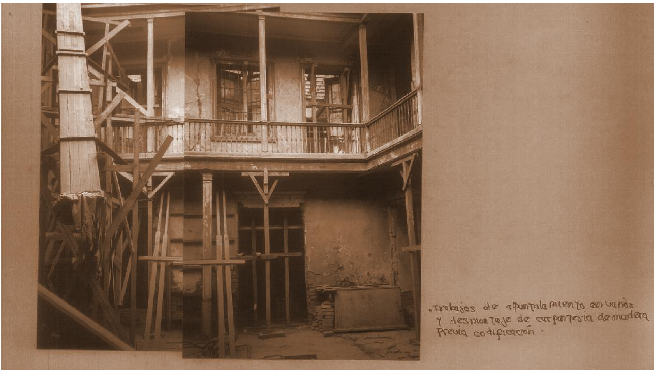
Figura 11. Vista de trabajos de apuntalamiento en vanos y desmontaje de carpintería de madera previa codificación. Fuente Arriola 1998.
