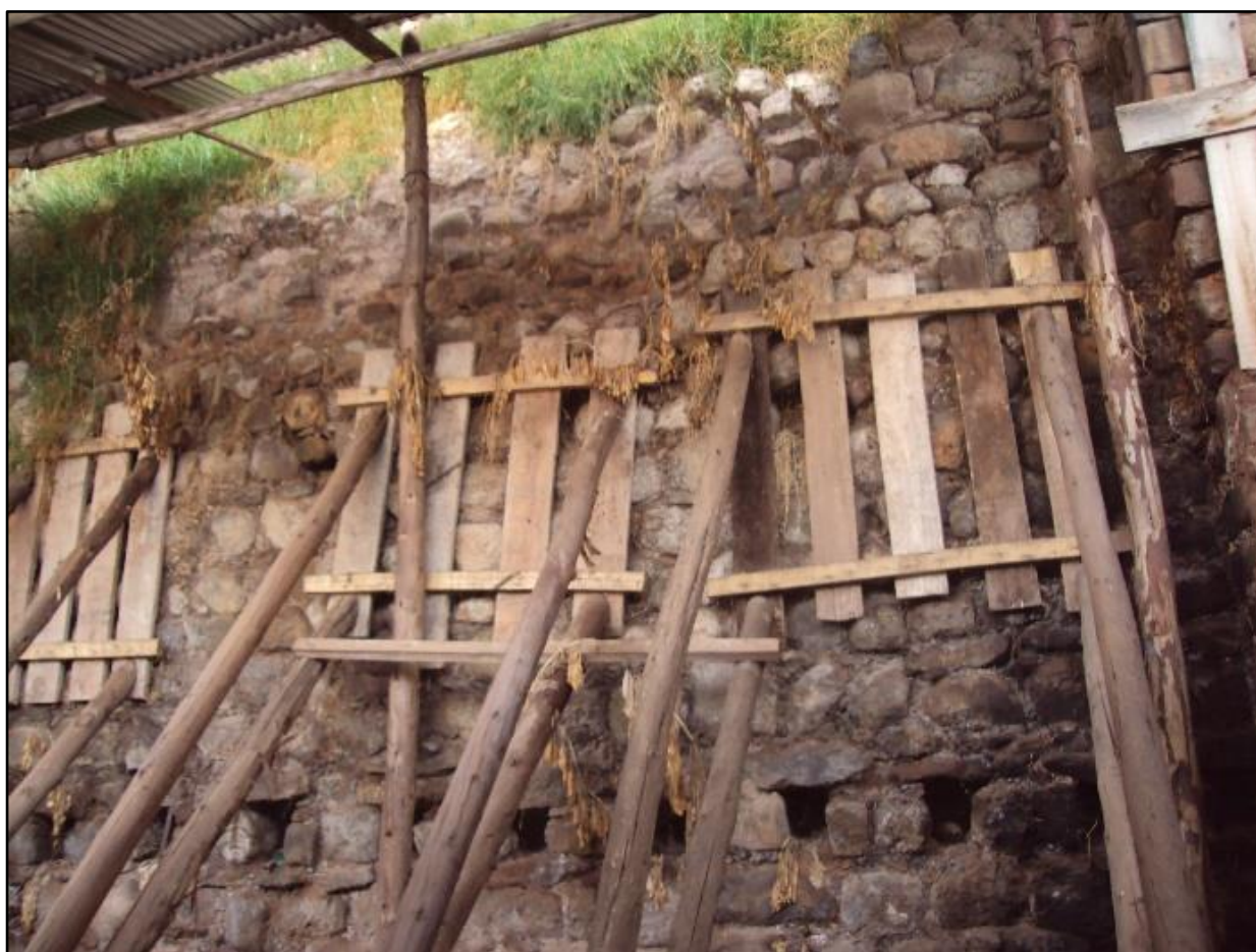
Figura 6: Muro en mal estado de conservación apuntalado por prevención.
