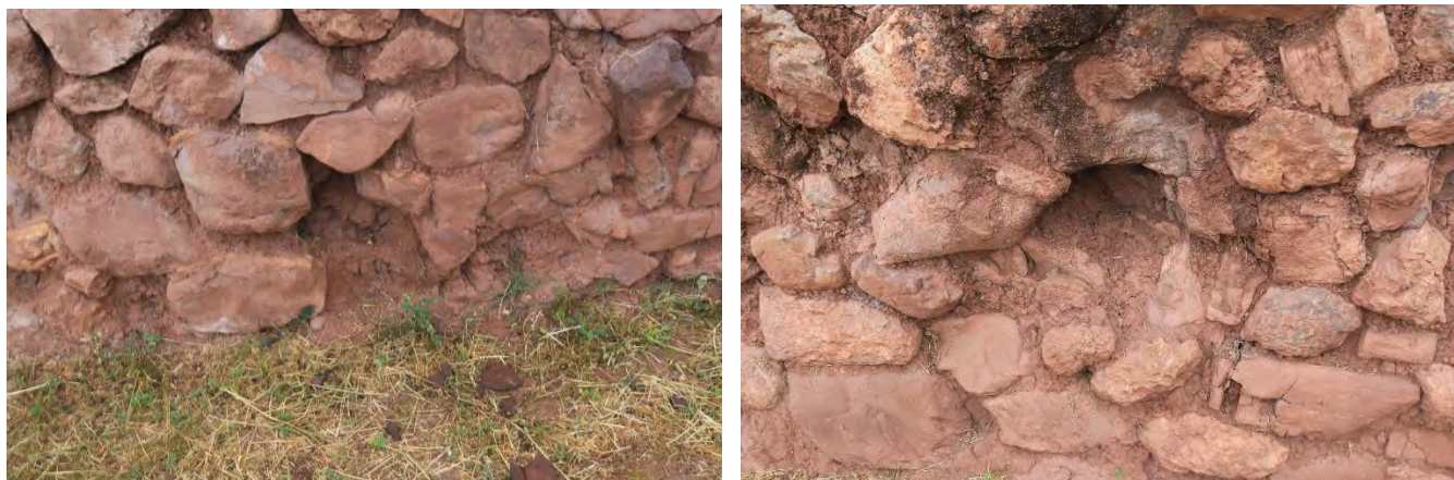
Figuras 10 y 11 Problemas de conservación identificados en los muros de las kallankas, sector bajo.
