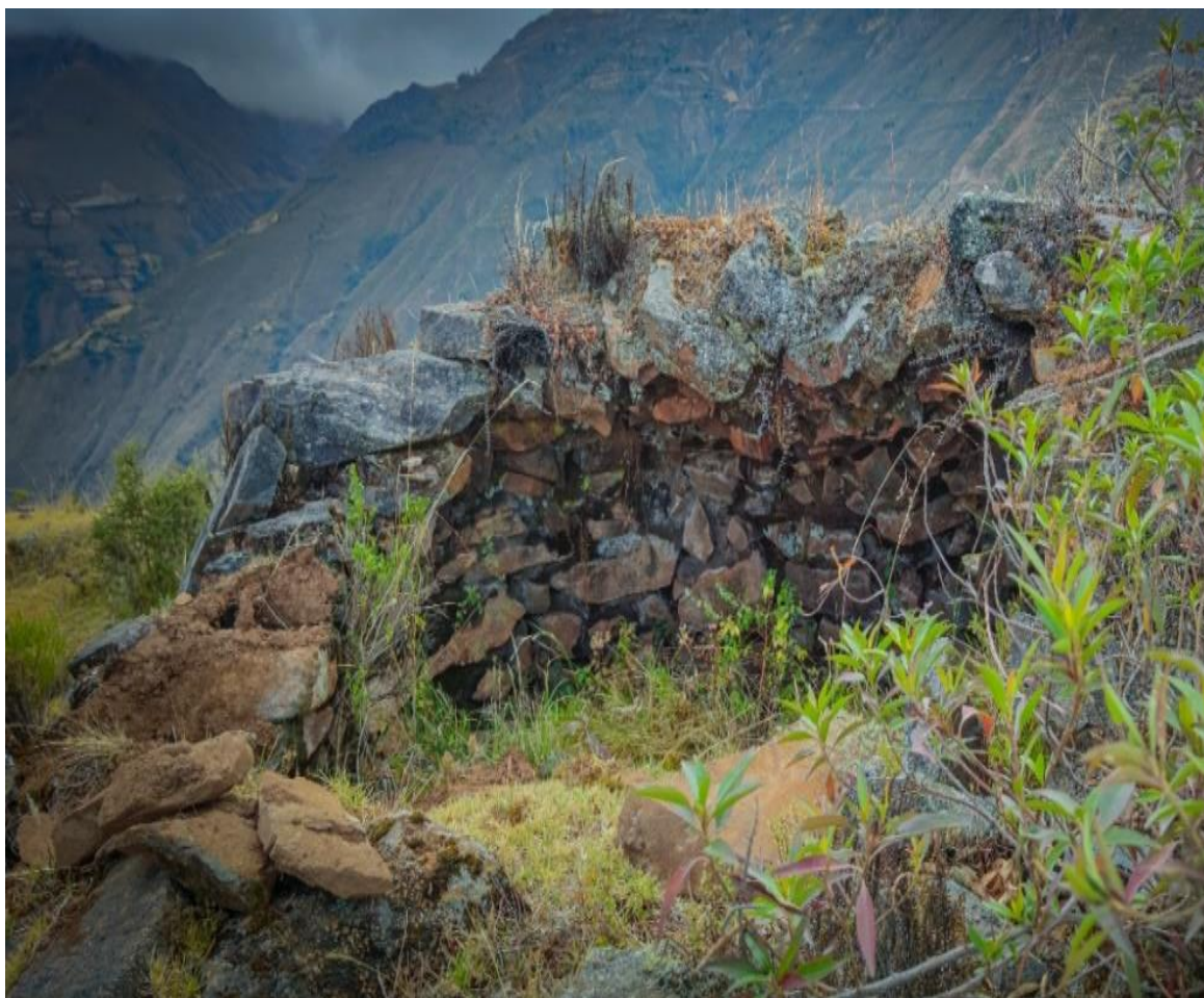
Figura 9: Vista del paramento interior de la Chullpa N° 1. Tomado desde el lado sur
