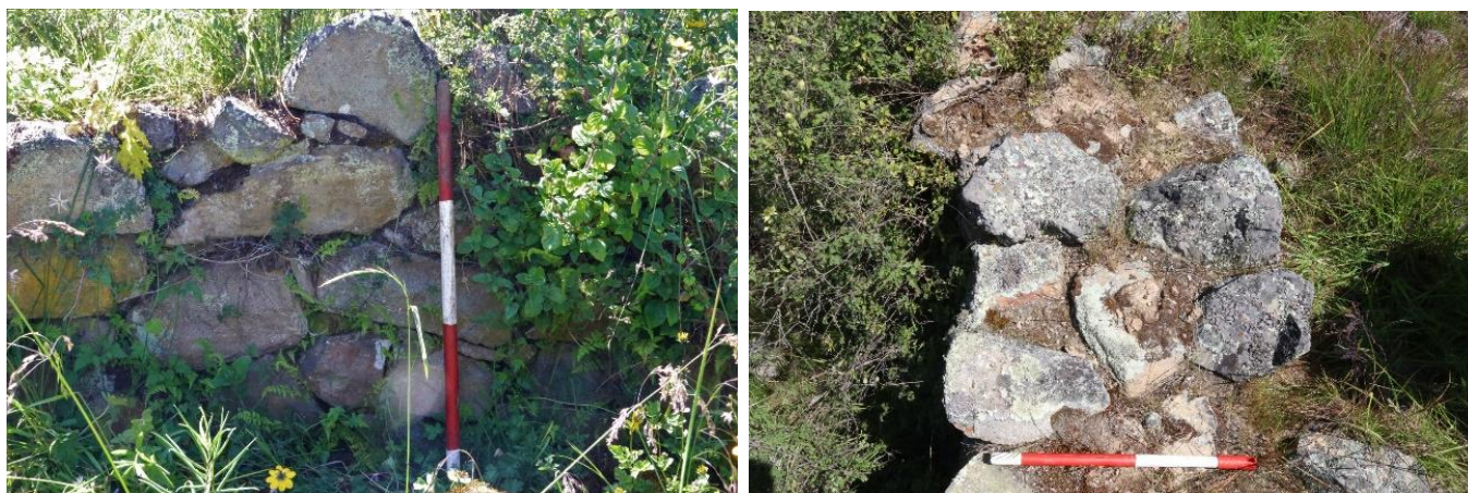
Figura 6 (izquierda): paramento interior de las estructuras circulares. Figura 7 (derecha): cabeceras de muros de estructuras circulares.
