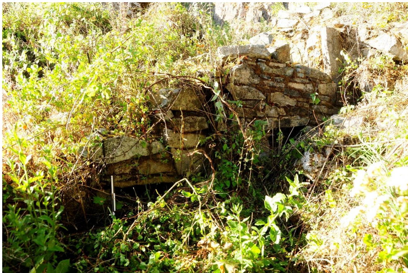
Figura 105: Chullpas unidas cubiertas de vegetales arbustivos y gramíneas. se halla destruidas parcialmente.
