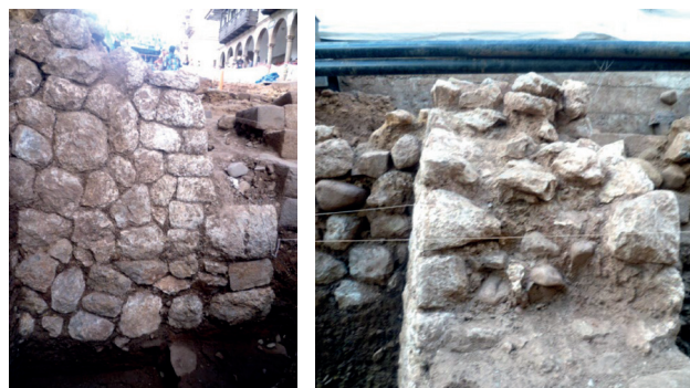
Figuras 59 y 60. Vista de fotos de detalle de desgaste.
