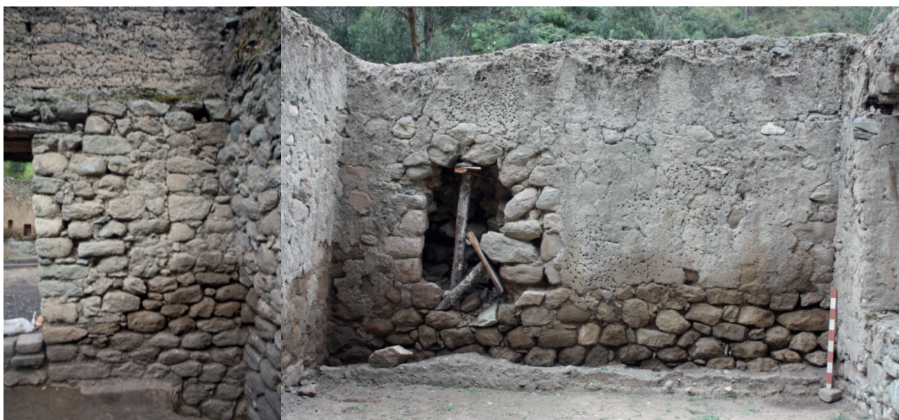
Figura 34. Modificaciones y tapiado de elementos estructurales.
