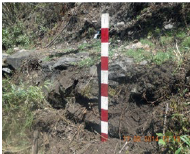
Figura 38. Estado de conservación de muros de sostenimiento deteriorados por invasión de plantas nativas.
