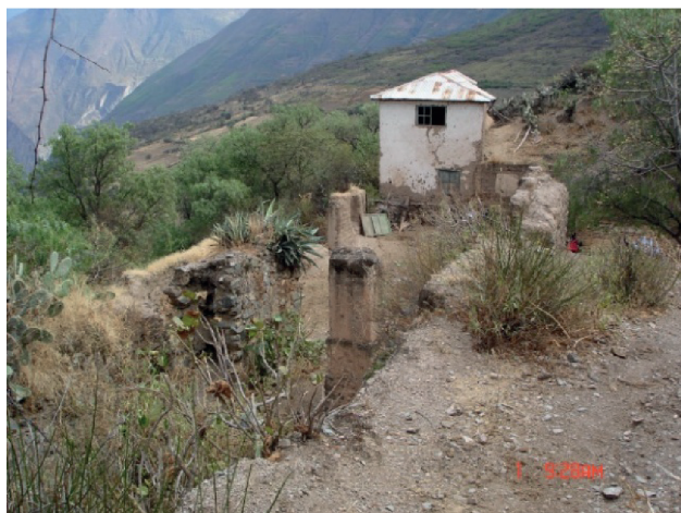
Figura 10. Hacienda en proceso de solapsamiento.
