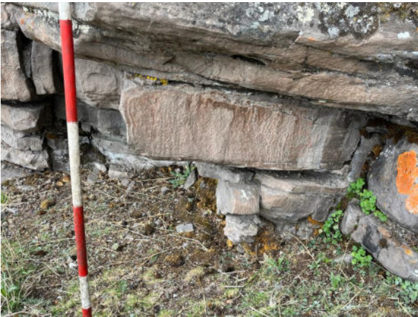
Figura 39. Vista de lado N-S del panel N° 3, nótese el mal estado de conservación del soporte.
