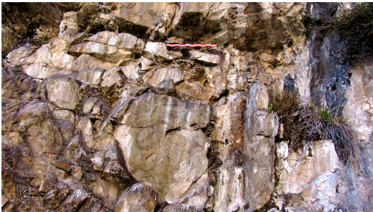
Figura 3. Sección de la pared de roca con siete paneles de quilcas, las cuales han sido afectadas por meteorización y grafiti. Foto por Fernando Vilca, 2017.
