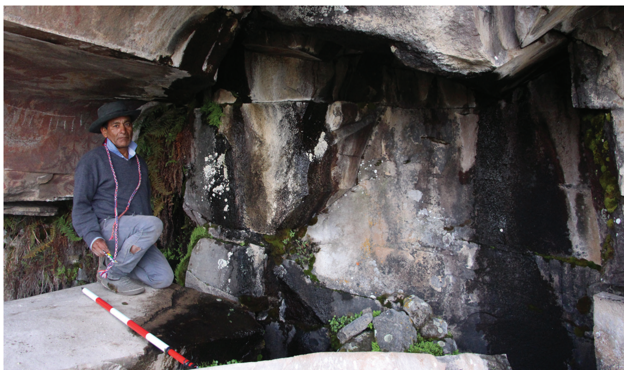
Figura 61. Pared de roca de en el fondo del machay norte, cubierto de rastros de escorrentías y chorreras de agua activa; además de colonias vegetales. Fotografía por Gori-Tumi 2024.
