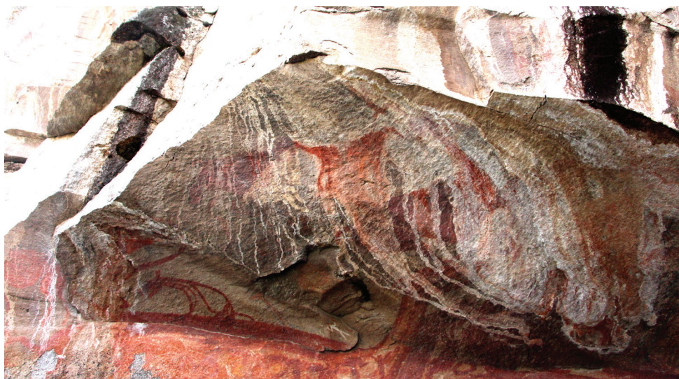
Figura 62. Faceta superior izquierda del panel 17 mostrando diferentes eventos de deposición mineral, principalmente de compuestos como el carbonato de calcio. Esta afectación es grave y produce un deterioro en las quilcas, como se puede ver en la imagen. Fotografía por Gori-Tumi 2024.
